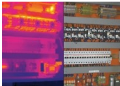
u rasklopnom ormaru
