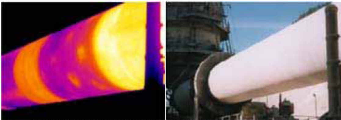
Termička slika pokazuje oštećenja u vatrostalnom materijalu u ovoj vrsti peći.
